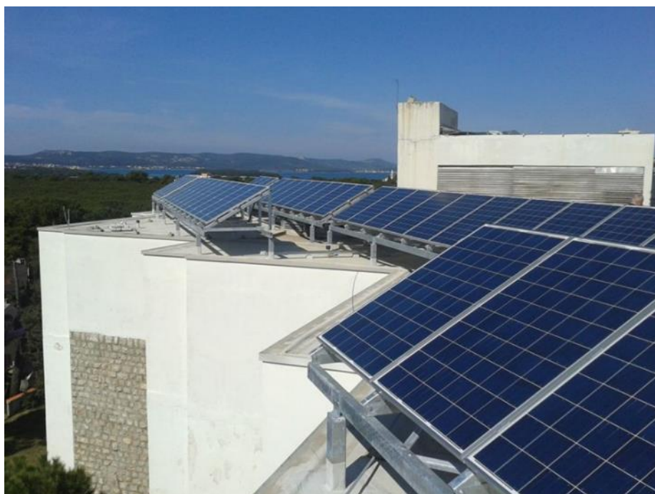
Slika 1 Fotonaponski paneli na krovu Hotela Adria
